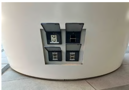
⑨ プラッツ柱電源
